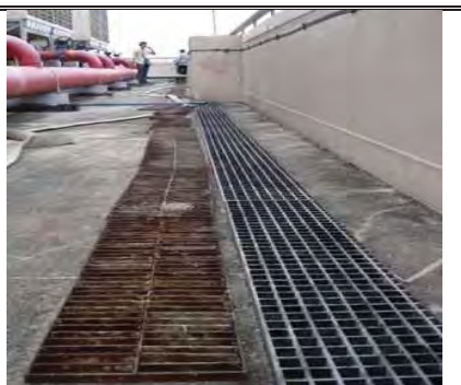
ติดตั้งบนดาดฟ้าของโรงพยาบาล
